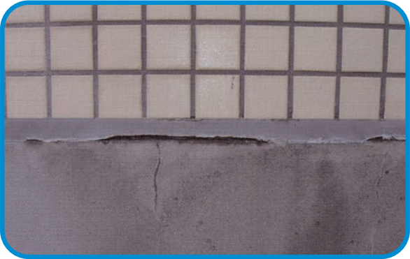
シーリング材の劣化・剥離
