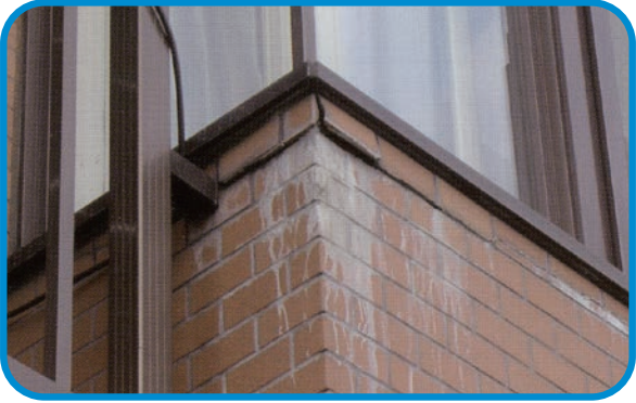
サッシ廻りタイルの浮き
