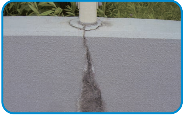
手摺り部分のひび割れ
