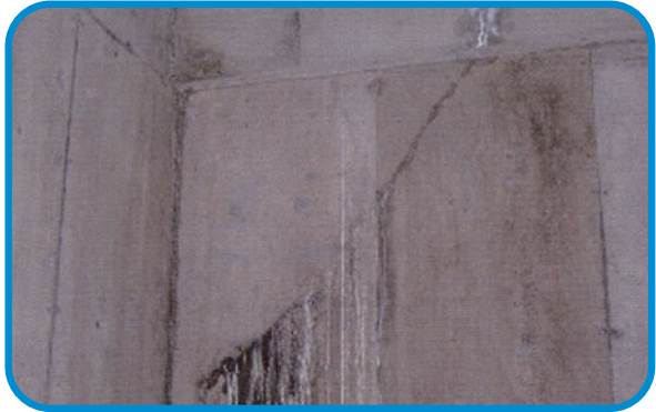
ひび割れからの漏水
