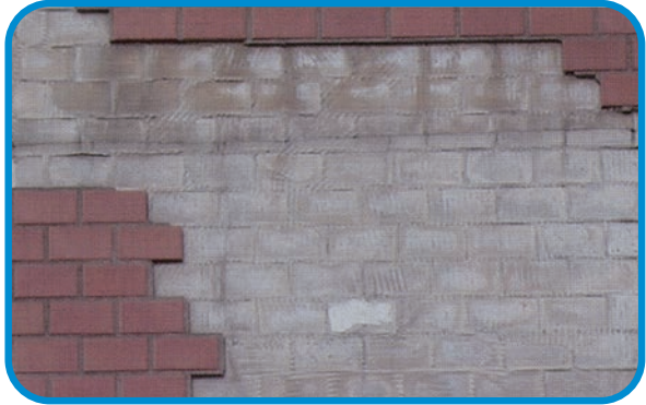
タイル張り外壁の浮き
