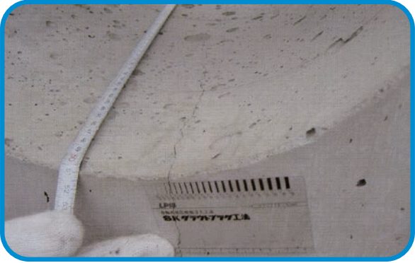
コンクリート構造物のひび割れ
