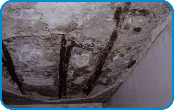
コンクリートの露筋、欠損
