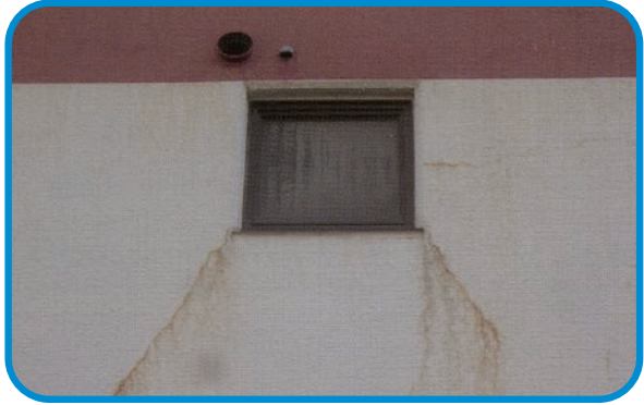
外壁のひび割れ
